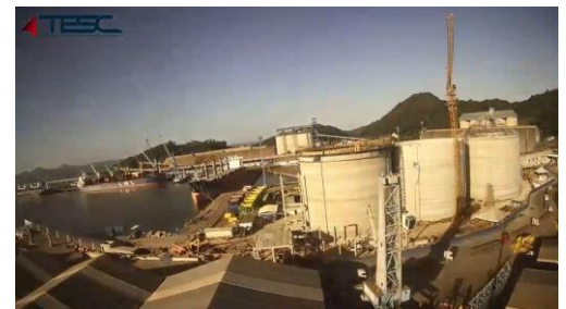
Silos de armazenamento à direita e equipamento com esteiras de transporte emergindo à esquerda
